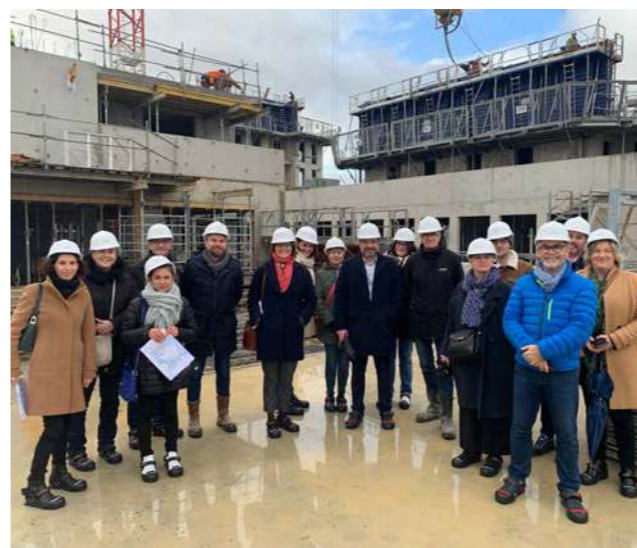
Visite du chantier d'Odacité : les membres du CSE découvrent les espaces du futur siège d'Espacil dans le quartier de Maurepas à Rennes.
